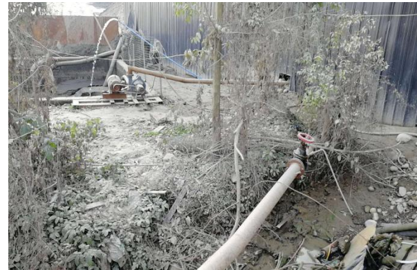
循环用水管道
