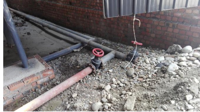
循环用水管道
