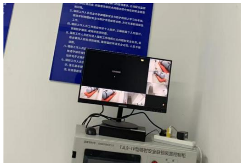
图 3-6 机房内监控系统
