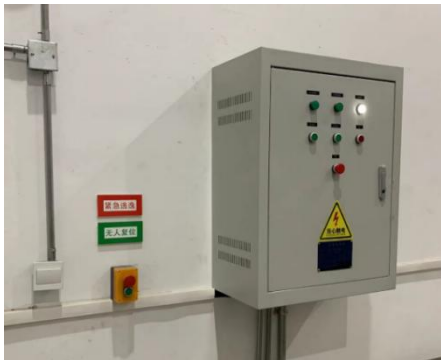
图 3-5 机房内紧急制动按钮
